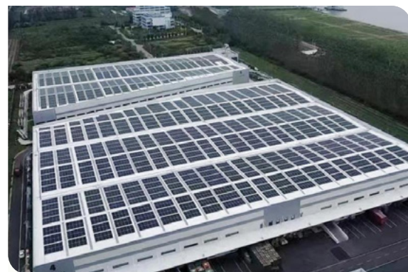
汉南捷悦行光伏发电项目
