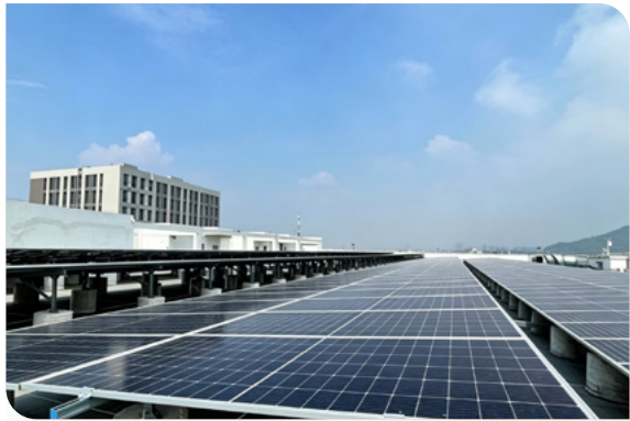
启润仓库光伏板
