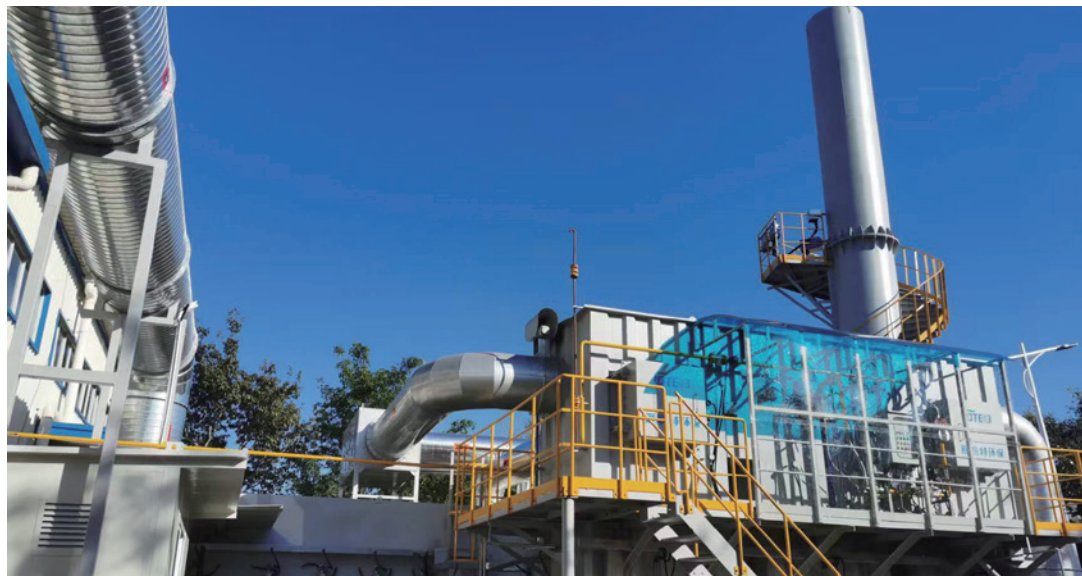
I VOCs 废气处理设施
