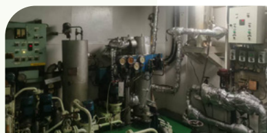
辅机燃油供油单元电加热器
