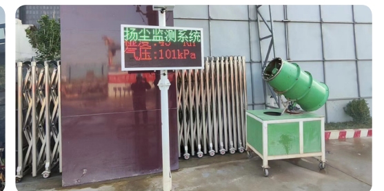
▲ 扬尘监测仪及雾炮
