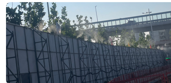
▲ 工地围挡喷淋
