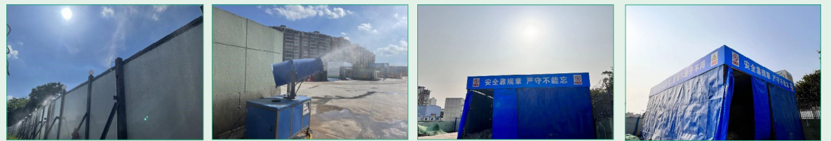
围挡喷淋系统
